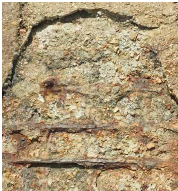
Primjer korozije prouzročene napadom klorida.
