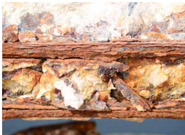
Primjer propadanja betona zbog hrđanja armaturnog željeza.
