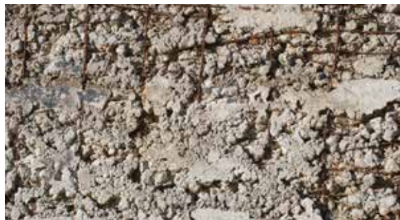
Primjer odvajanja agregata u betonu.
