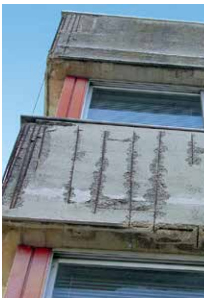
Beton s ogoljenim armaturnim željezom od propadanja.
