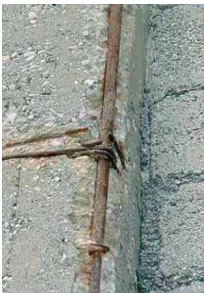
Propadanje sloja betona koji pokriva željezo u jednom betonskom polustupu.
