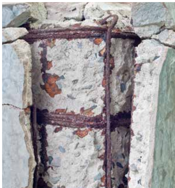
Izbacivanje sloja betona koji pokriva željezo zbog hrđanja armaturnog željeza.
